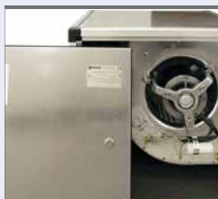
Pannelli smontabili per ispezione motore
